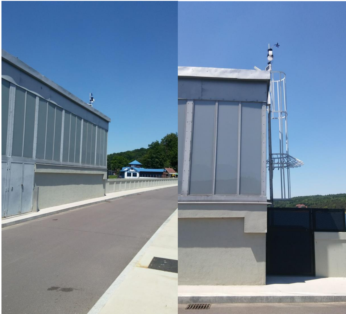
Obr. 37. Nově zřízená meteorologická stanice na hrázi Vranova.
